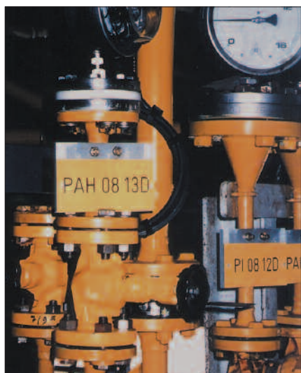
Isolamento de uma válvula transmissora de pressão em cloro gasoso - França
